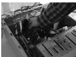
Рис. 2-1. Монтаж платы видеоввода
